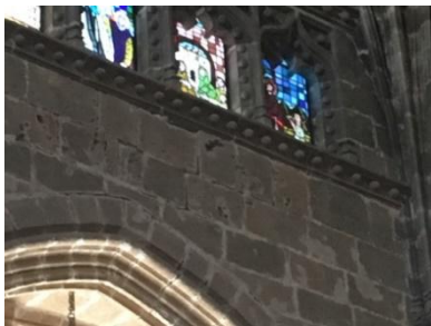
Fissures i filtracions
