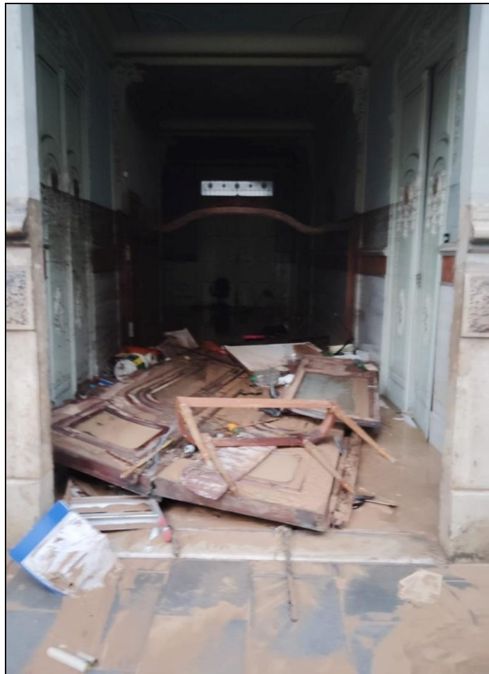
Façana principal d'una casa afectada per la DANA a Catarroja datada als inicis del segle XX
