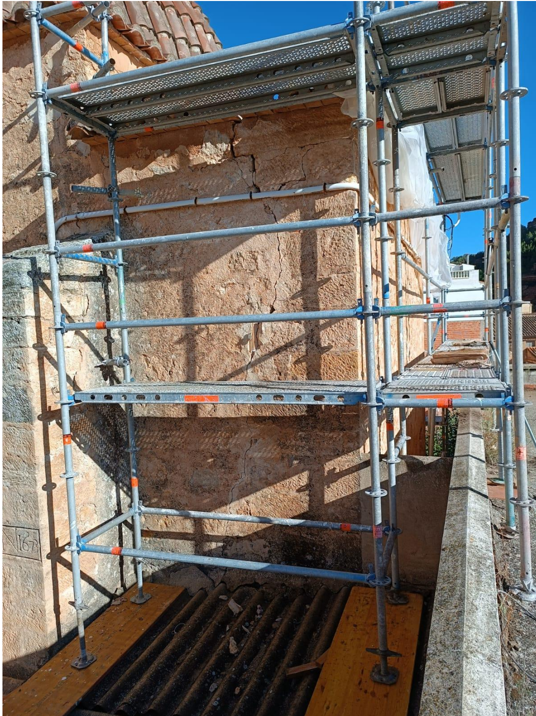
Fig. 3.3.6_Colocación de medios auxiliares. Se aprecia la grieta en la esquina del muro.
