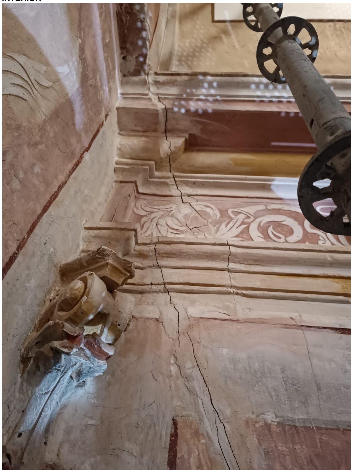
Fig. 3.3.14_Detalle del aspecto de las grietas anteriormente presentes en el interior.
