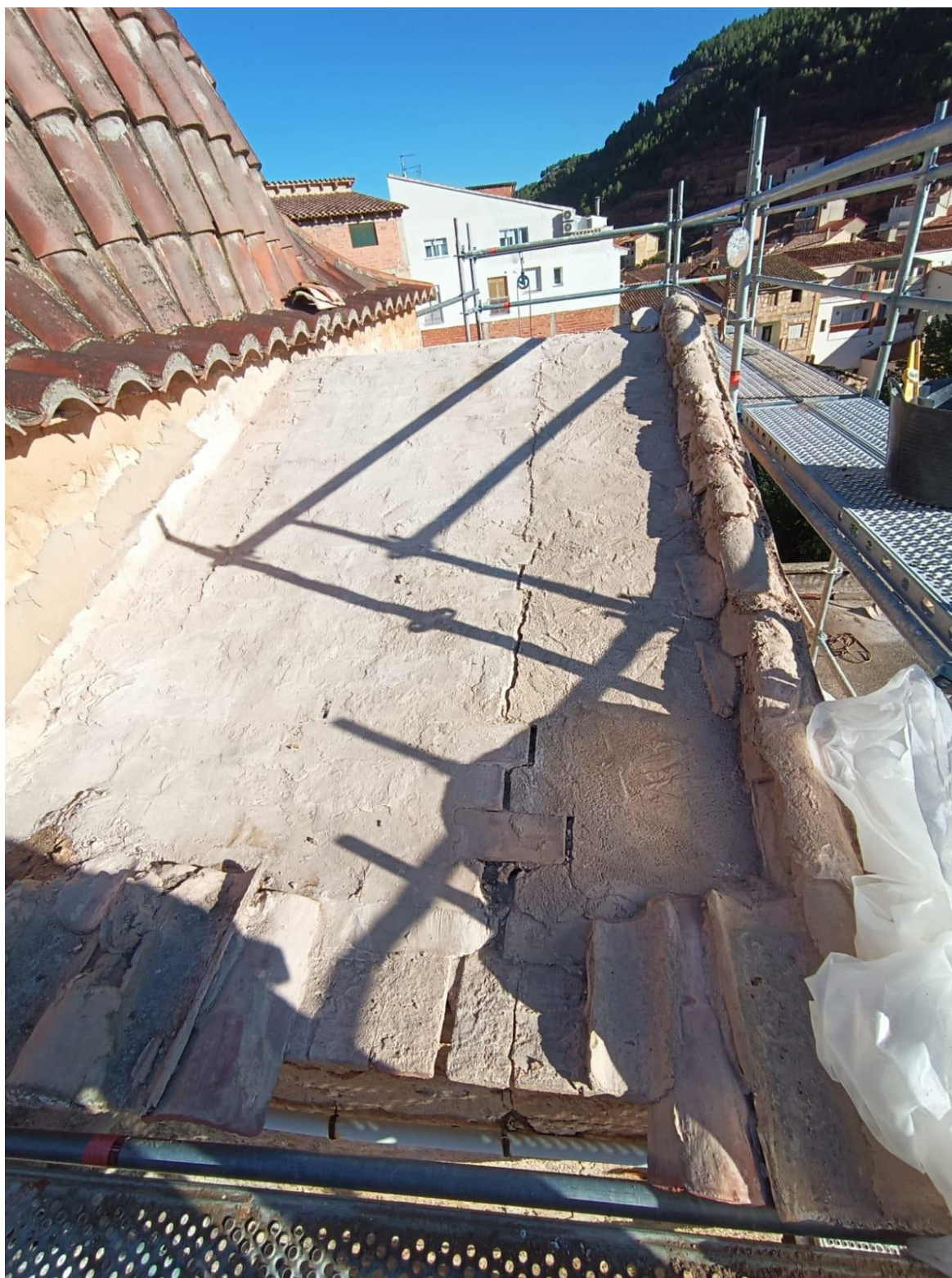
Fig. 3.3.7_ Aspecto de la cubierta una vez retiradas las tejas. Se aprecia la grieta longitudinal que parte de la esquina del muro.
