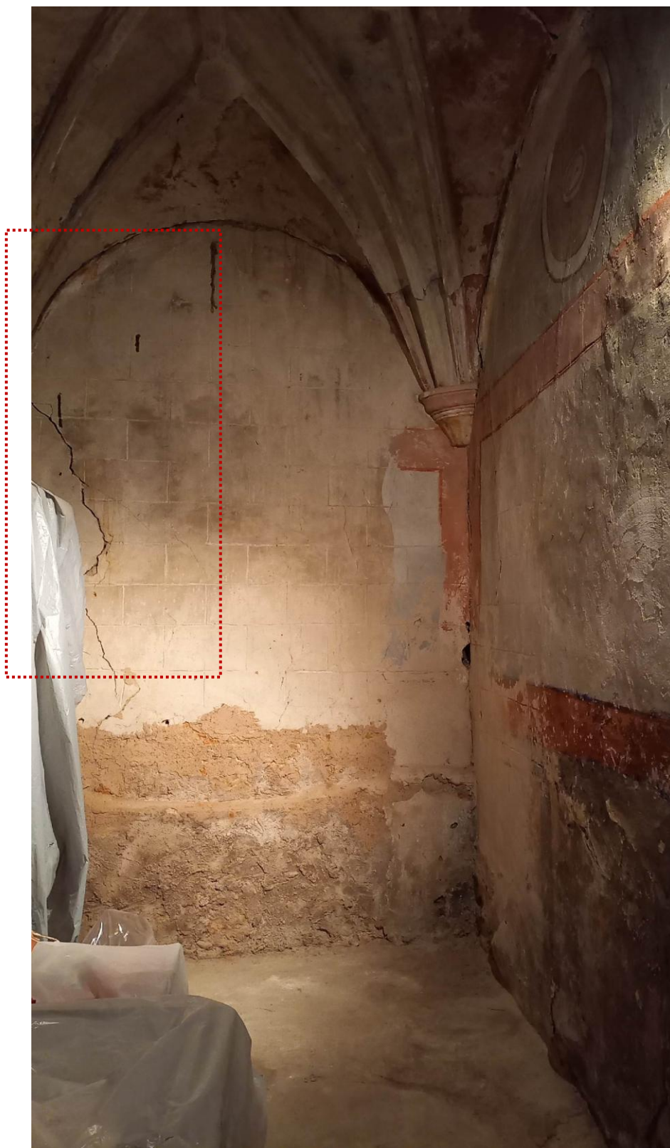
Fig. 3.3.4_ Grieta de esquina de la capilla lateral norte vista desde el interior, antes de la intervención.
