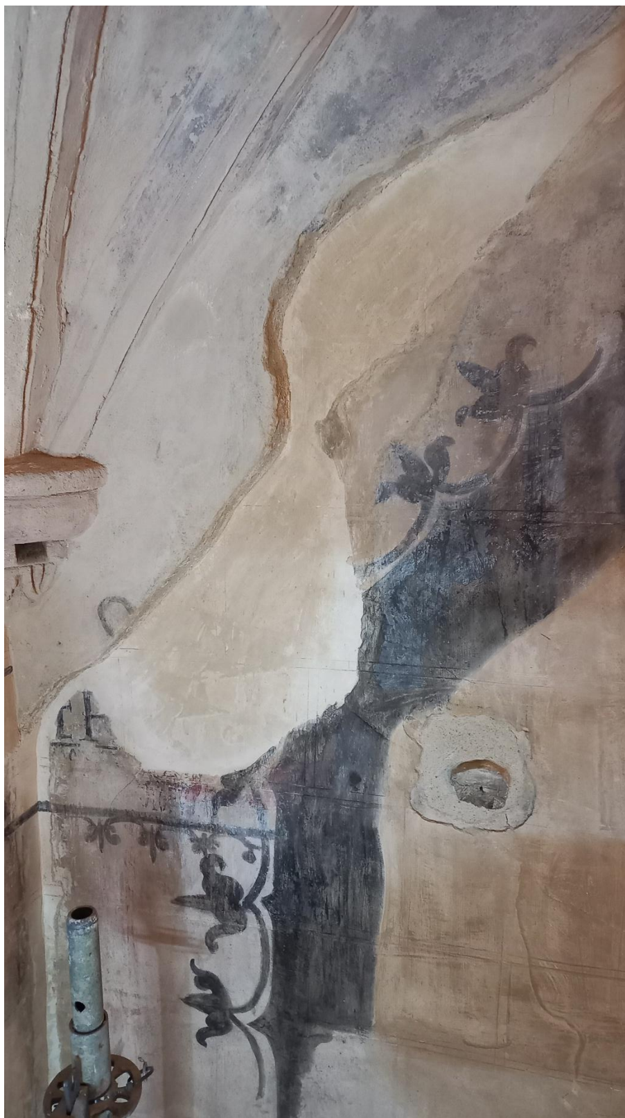
Fig. 3.2.11_ Interior de la capilla. Detalle de los restos pictóricos del paramento frontal.
