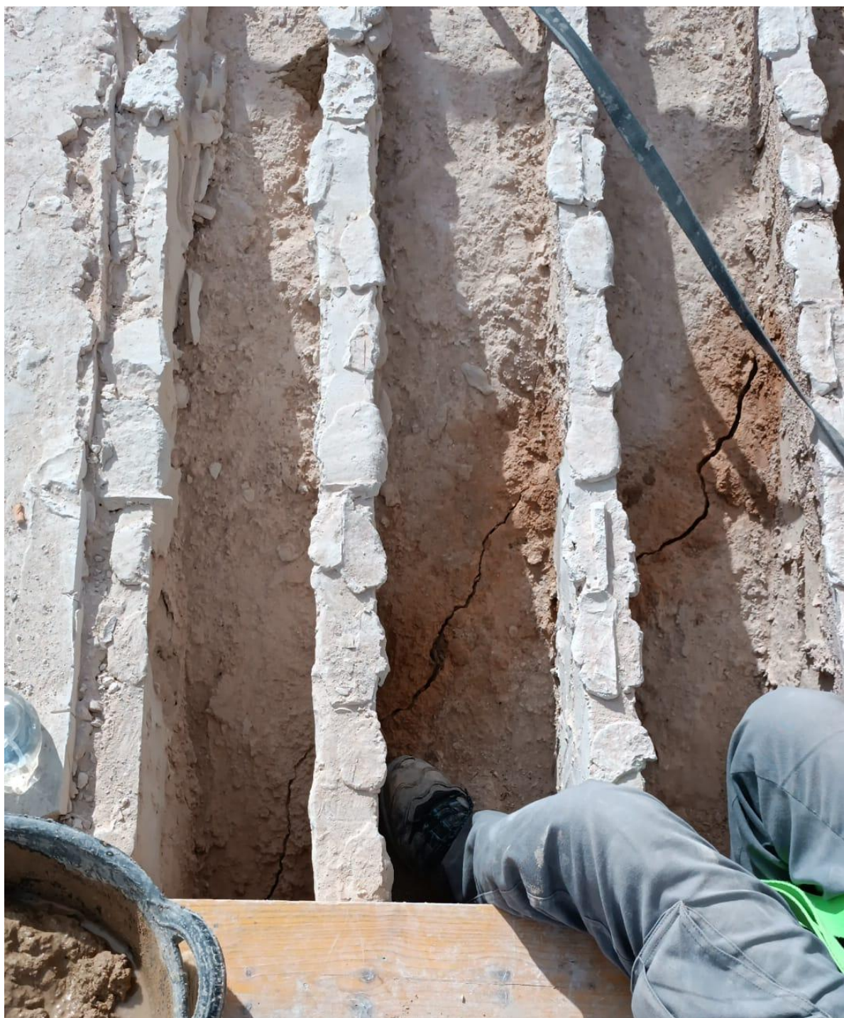
Fig. 3.3.9 Tabiquillos cerámicos como sistema de soporte del tablero cerámico. Se parecía la grieta longitudinal que recorre la bóveda, cuyo trazado parte de la grieta de la esquina del muro, que se interviene mediante cosidos.
