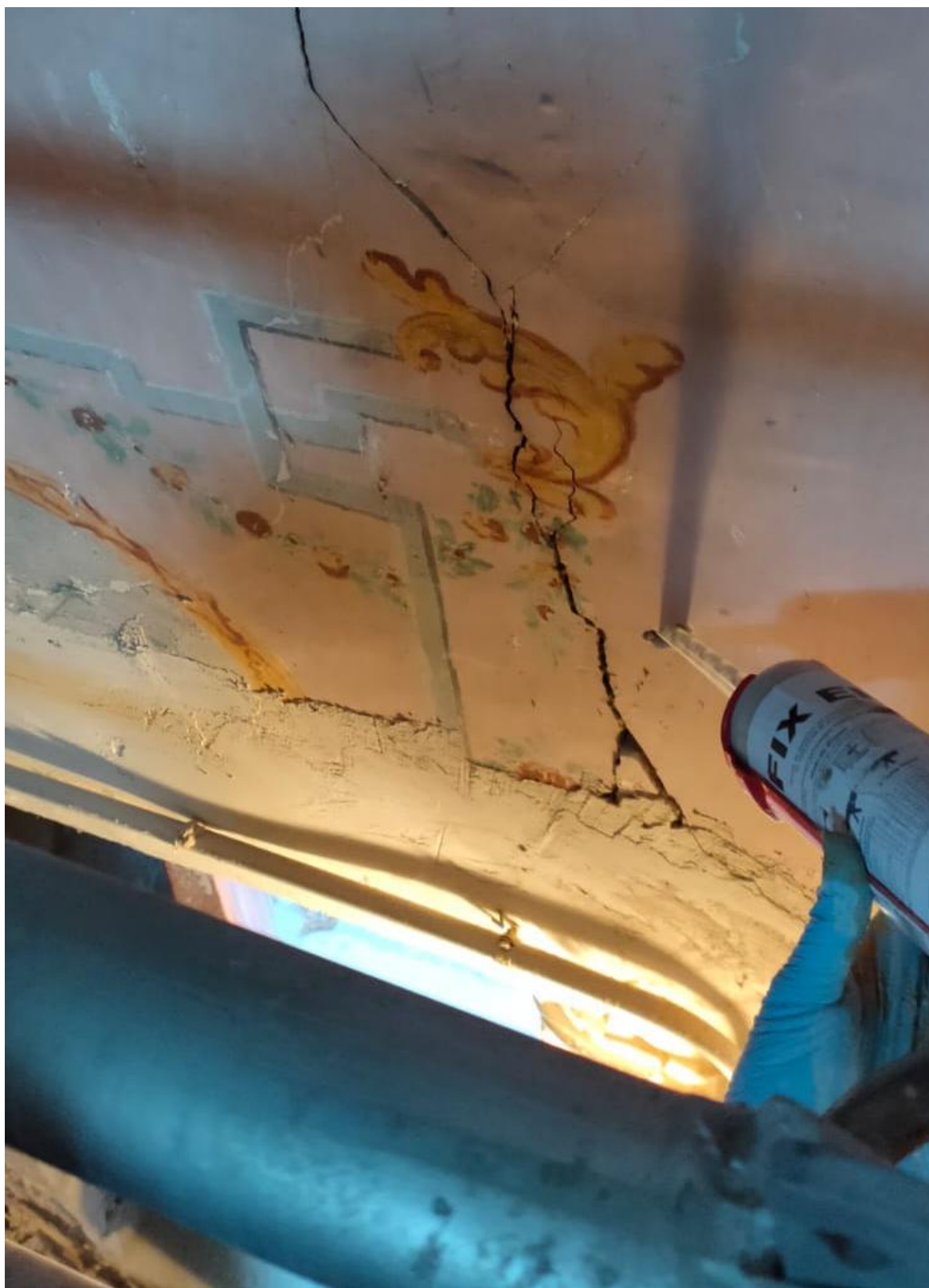
Fig. 3.1.7_ Cosido de grietas mediante varillas de fibra de vidrio. Los restos pictóricos de la imagen corresponden al s.XIX.
